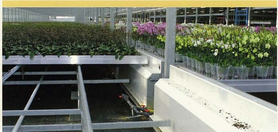
De JSK-koelunits staan onder de goot tussen de teelttafels. Ze zuigen van boven lucht aan, koelen of verwarmen deze en blazen de lucht vervolgens horizontaal onder de teelttafels de kas in.
